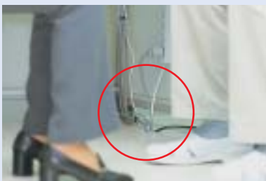
配線はすべて床下に収納されるように設計されています。
